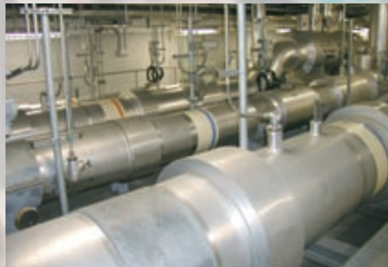
黄色いビルの下の地域冷暖房システム
