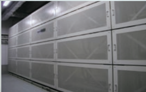
ラクーアビルの地下の NAS 電池
