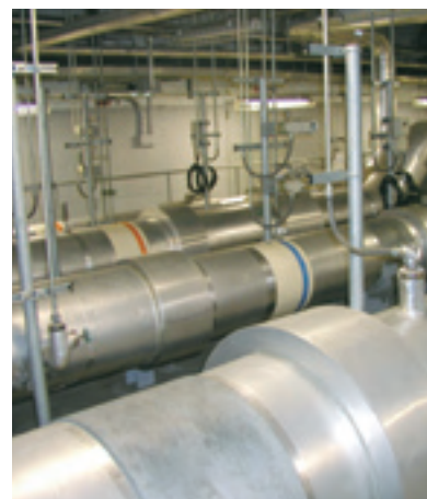
黄色いビル下の地域冷暖房システム
