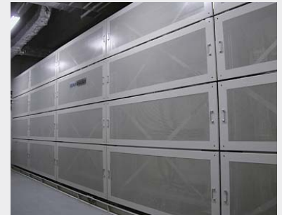
ラクアのNAS電池システム
