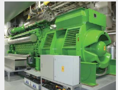
常設の自家用発電機
