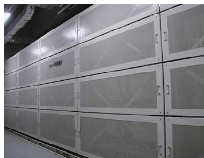
ラクーアのNAS電池システム
