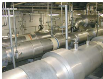
黄色いビル下の地域冷暖房システム
