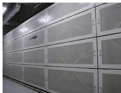
ラクーアのNAS電池システム
